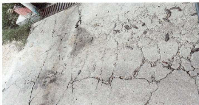
FOTO 1: Sustrucción de piso de torta de concreto
