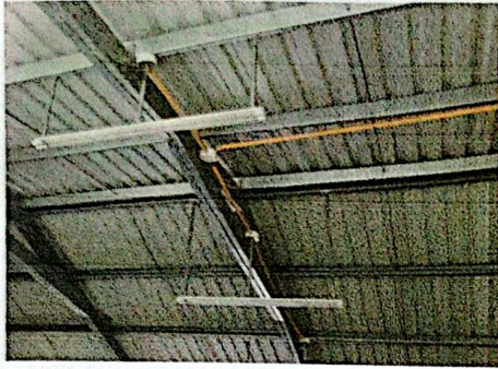
Foto 1: Instalación para acometida eléctrica
