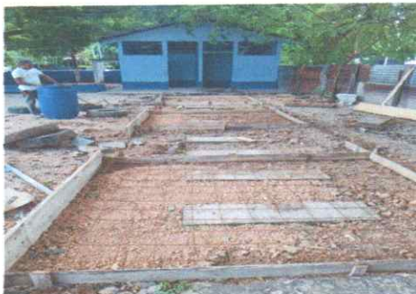
Foto 1: Sustrucción de piso torta al acceso de baños
