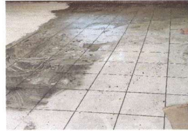
Foto 14: Sustrucción de piso cerámico ✓
