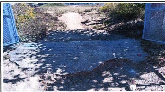
Foto 4: Vista de la losa de entrada, se observa deteriorada y en general en malas condiciones.
