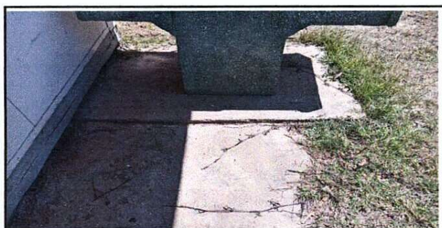
Foto 5: Vista de losa de patio, se encuentra deteriorada, en general en malas condiciones.
