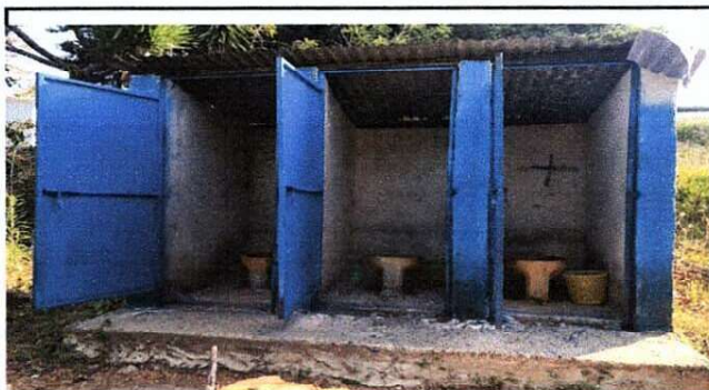
Foto 3: Vista del interior de las letrinas, las cuales se observan deterioradas y en general en malas condiciones.
