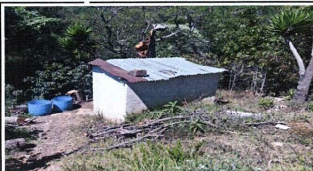
Foto 2: Vista trasera del modulo de sanitarios, se observa la lamina oxidada y podrida, en general se encuentra en malas condiciones.
