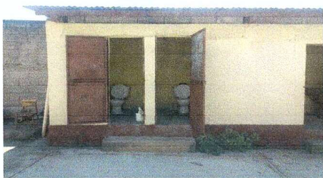
Foto 3: SERVICIOS SANITARIOS Y SUS ACCESORIOS
