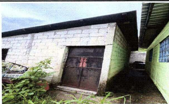
Foto 1: REPELLO DE PARED DE COCINA
