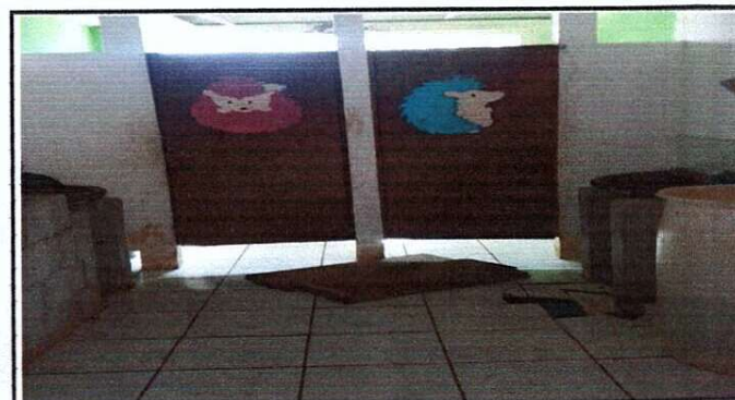
Foto 4: Puertas y paredes dañadas en sanitarios.
