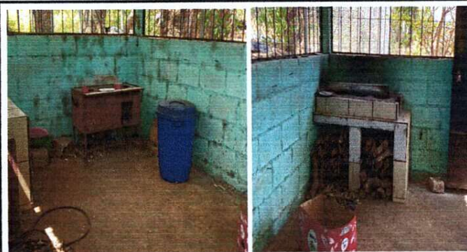
Foto 1: Piso de Cemento a mejorar, Paredes a repellar, ampliación de desayunador y polleton en mal estado a mejorar.
