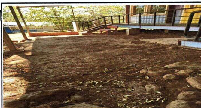
Foto 5: Área de corredor destinado a consumo de alimentos con piso de tierra a mejorar con torta de cemento.
