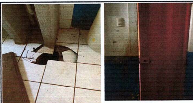
Foto 3: Piso, Puerta y chapas dañadas en sanitarios.
