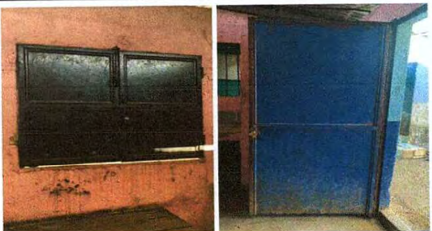
Foto 3: MODULO COCINA: Reparación de puerta de metal en mal estado y pintura, reparación de ventana de metal y pintura.
