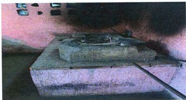
Foto 1: MODULO COCINA: Mejoramiento de polletón y repello en mal estado, repello y cernido en pades block en mal estado internas y externas.
