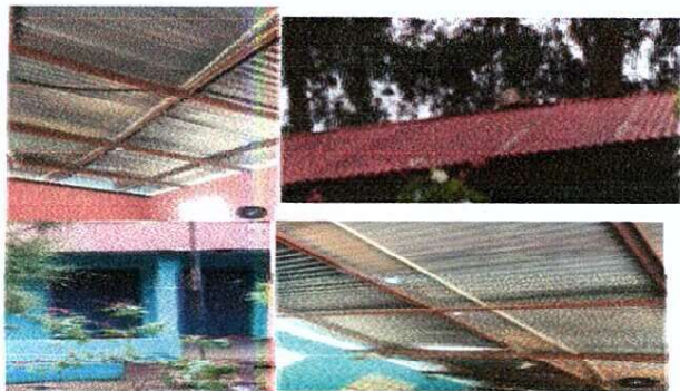
Foto1: MODULO DE AULA Lámina mal estado , capote de lámina mal estado , estructura portante de metal ,2 puertas de metal mejorar.
