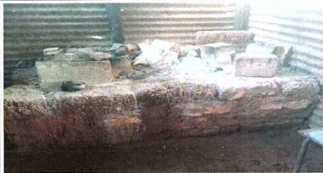
Foto 10: Estufa rural de barro deteriorada a sustituir por polletón de block y concreto en cocina (incluyendo plancha metálica y chimenea)
