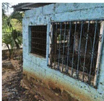
Foto 3: Ventana con barrotes metálicos a mejorar en area de cocina
