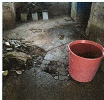
Foto 4: Area de cocina sin polletón y sin desayunoador, torta de cemento dañado y paredes internas sin repello.
