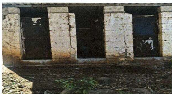
Foto 5: Paredes de sanitarios dañadas parar reparar y ampliar
