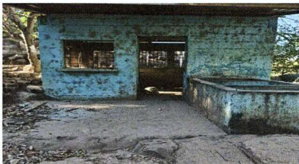
Foto 1: Cocina en mal estado (paredes húmedas, sin repellar en area interna y torta de cemento agrietada)
