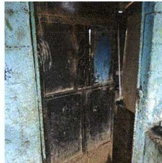
Foto 2: Puerta de metal en mal estado a mejorar en el area de cocina
