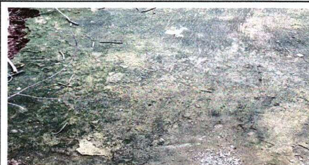
Foto 6: Mejoramiento del piso con concreto deteriorado
