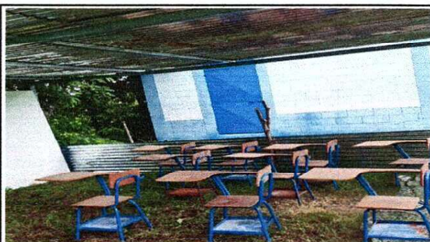
Foto 4: Falta de block y de cemento
