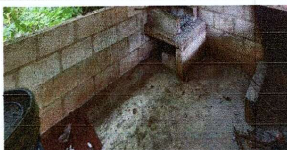
Foto 8: Piso de torta de concreto en cocina en mal estado a sustituir con piso de granito.
