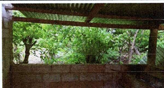
Foto 7: Estructura de soporte de madera en malas condiciones, lámina metálica dañada y de mala calidad a sustituir en cocina.
