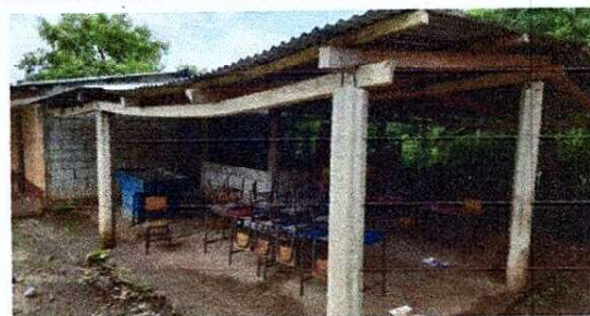
Foto 2: Piso de torta de cemento de aulas en mal estado a sustituir con piso de granito
