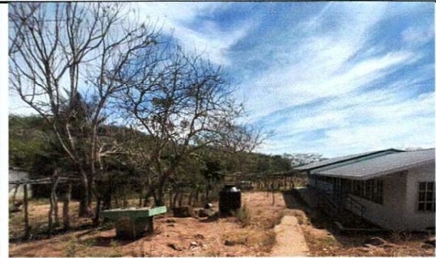
Foto 4: MURO PERIMETRAL DE MALLA METALICA Y TUBO GALVANIZADO
