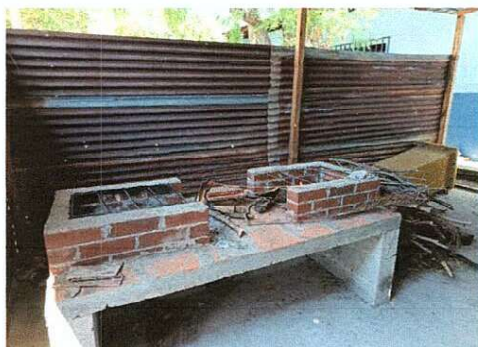
Foto 1: ESTUFA RURAL EN MAL ESTADO, SE INSTALARA PLANCHA Y SISTEMA DE EXTRACCION DE HUMO
