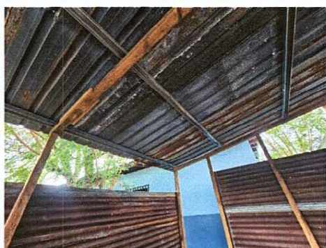
Foto 3: LAMINA EN MAL ESTADO Y ESTRUCTURA DE MADERA EN MAL ESTADO
