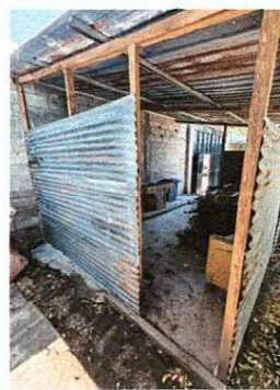
Foto 4: BIODIGESTOR DAÑADO OCACIONANDO CRIADERO DE ZANCUDOS
