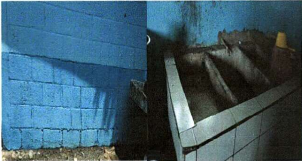
Foto1: PAREDES DE COCINA EN MAL ESTADO
