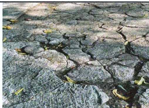
Foto 4: Torta en mal estado
