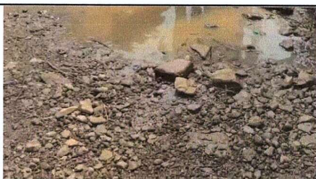
Foto 5: posa de agua en torta en mal estado
