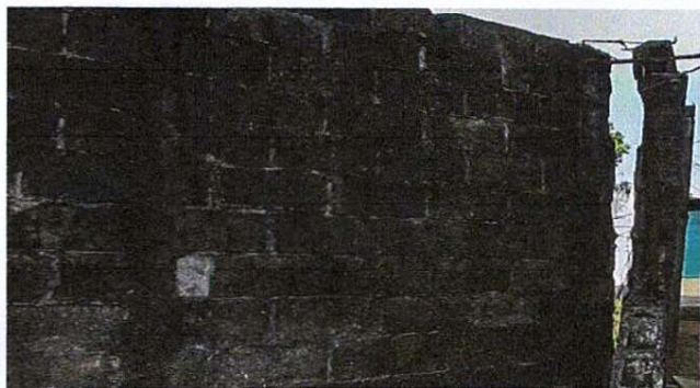
Foto 1: Muro perimeetral en deterioro lateral izquierdo
