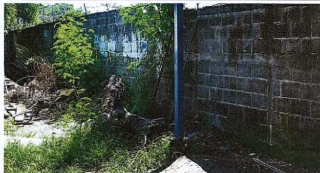
Foto 2: Muro perimeetral en deterioro lateral izquierdo
