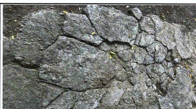
Foto 6: deterioro de torta
