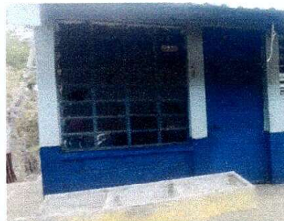
Foto 2: VENTALES DE LA COCINA QUEBRADOS
