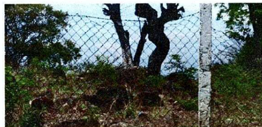
Foto 6: MALLA METALICA EN MAL ESTADO
