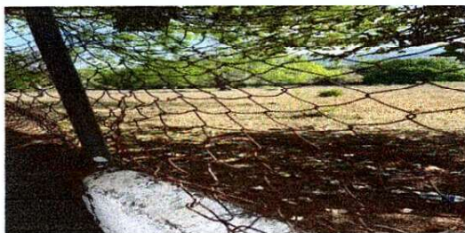
Foto 5: MALLA METALICA EN MAL ESTADO
