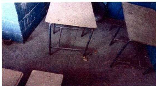
Foto 4: TORTA LISA EN MAL ESTADO
