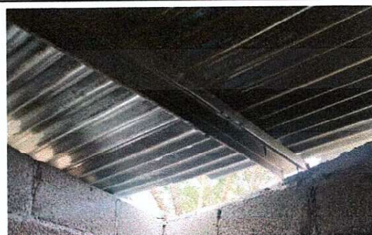
Foto 4: 1. Mejoramiento de Cubierta de lamina
