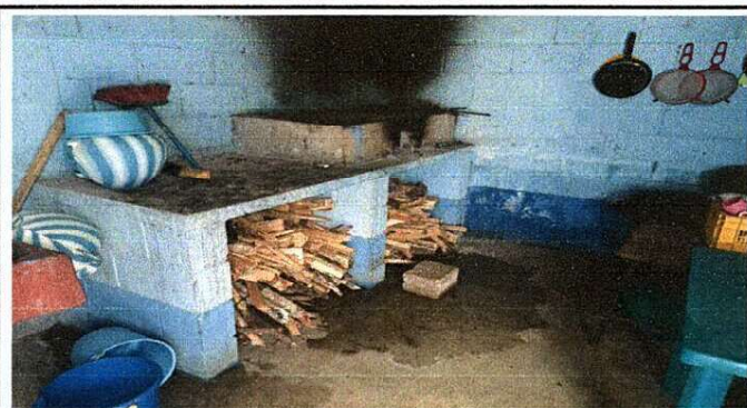
Foto1: Remozamiento de estufa y chimenea. Se necesita la reparación del mismo.
