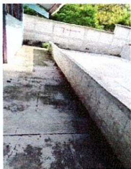
Foto 9: Reparación de grietas en el Corredor de la Escuela
