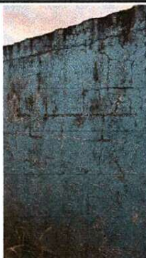
Foto3: PINTURA DETERIORADA EN MURO PERIMETRAL
