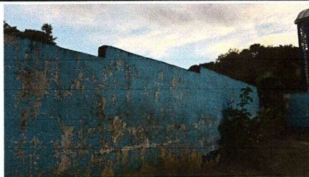
Foto 4: PINTURA DETERIORADA EN MURO PERIMETRAL
