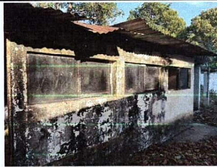
Foto 2: : MODULO DE COCINA NECESIDADES: BALCONERIA, MEJORAMIENTO DE VENTANAS
