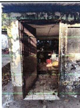
Foto3: MODULO DE COCINA NECESIDADES: MANTENIMIENTO DE PUERTAS
