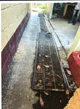
Foto 3: MODULO DE COCINA: MEJORAMIENTO DE REJILLAS
