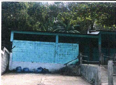
Foto 1: Aulas a mejorar
