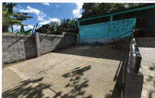
Foto 6: Aulas a mejorar
