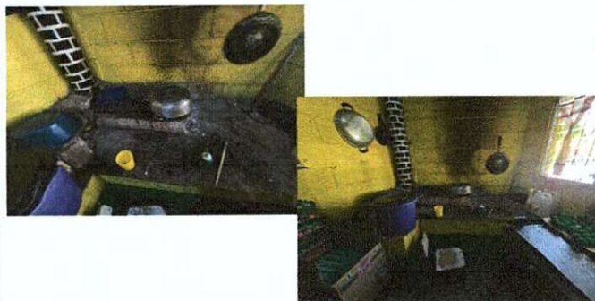
Foto 2: Area de cocina en mal estado, se mejorara la cocina de leña con su respectiva chimenea,se colocara azulejos.
