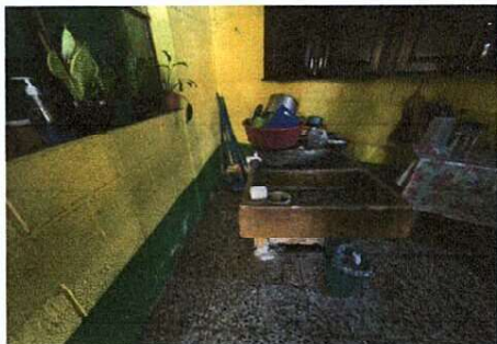
Foto1: Foto1: Pila y drenaje en mal estado, se mejorara con la construccion de una pila con su respectivo drenaje
