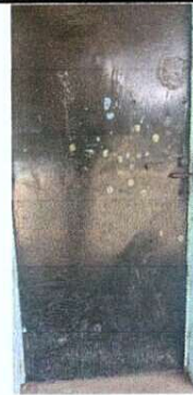
Foto 4: MODULO DE AULAS NECESIDAD: MEJORAMIENTO DE PUERTAS, CORTE, PINTURA Y CHAPA.
