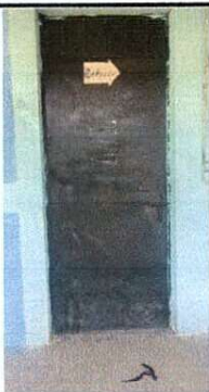
Foto 3: MODULO DE AULAS NECESIDAD: MEJORAMIENTO DE PUERTAS, CORTE, PINTURA Y CHAPA.
