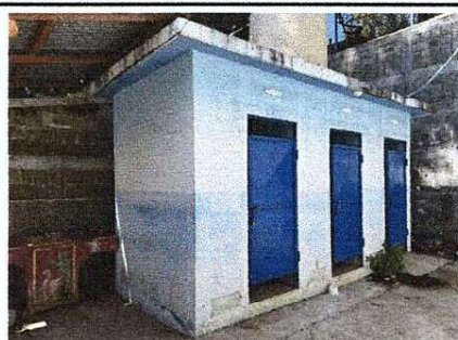
Foto 6: MODULO DE SANITARIOS NECESIDAD: PINTURA EN MUROS
