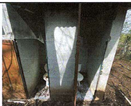
Foto 5: Servicios Sanitarios y sus accesorios
