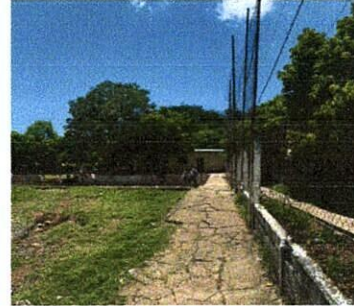
Foto 2: MURO PERIMETRAL EN MAL ESTADO
