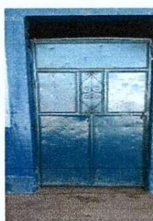
Foto 2: PUERTA DE METAL, MANTENIMIENTO
