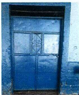
Foto1: PUERTAS DE METAL, MANTENIMIENTO
