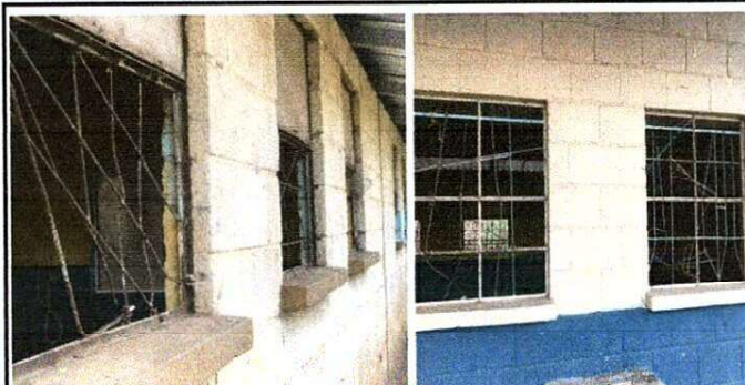
Foto 3: Reparación y mantenimiento de ventanas: Ventanas sin seguridad, presentan alto riesgo para los estudiantes.
