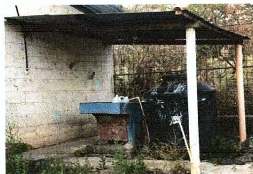
Foto 2: Reparación de cocina: No se cuenta con cocina cerrada, para preparar los alimentos se utiliza esta galera con una mesa y tonel como hornilla de leña.
