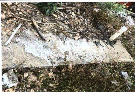
Foto 1: Fosa séptica: contiene el drenaje de la escuela primaria y del Centro NUFED, filtra el agua, se encuentra llena y por el mal nivel del suelo las aguas negras rebalsan por las alcantarillas.
