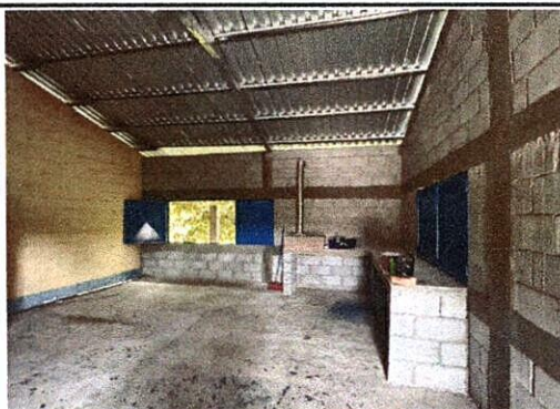
FOTO 3: TORTA DE CEMENTO DETERIORADA Y PICADA CON DESNIVEL
