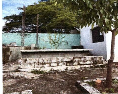
FOTO 2: BASE DE BAÑOS SIN TERMINAR Y SIN SERVICIOS INSTALADOS
