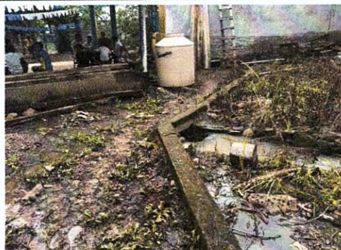
FOTO 2: AGUAS PLUVIALES QUE DESBORDAN EN EL PATIO DE LA ESCUELA Y CON CAJA DE REGISTRO QUE NO CUBRE LA NECESIDAD DE LA CAPACIDAD DE AGUA QUE RECORRE
