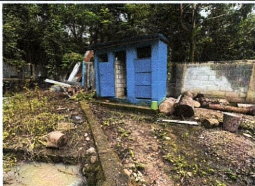
FOTO 1: CAMINAMIENTO HACIA SERVICIOS SANITARIOS EN PÉSIMO ESTADO CON AGUAS PLUVIALES POR LOS ÁLREDEDORES Y SIN BANQUETA O AREA PEATONAL
