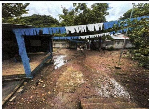
FOTO 3: AREA DE ACTIVIDADES Y PATIO DE LA ESCUELA CON DESBORDAMIENTO DE AGUA Y LODOS
