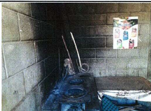
Foto 3: Cocina en mal estado que se sustituirá por una plancha, chimenea, pila, piso, pintura y puertas.
