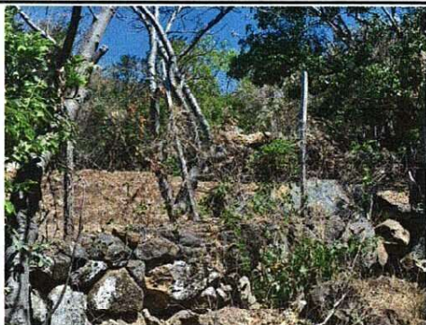
Foto 1: Perimetro de la escuela circulado por una tela metálica en mal estado que se sustituirá por un muro de bloques.
