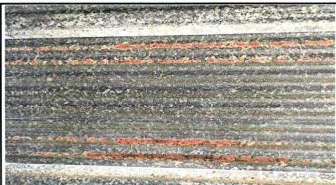
Foto 3: Lámina oxidada y en mal estado, se sustituirá por lámina troquelada aluzinc calibre 26.
