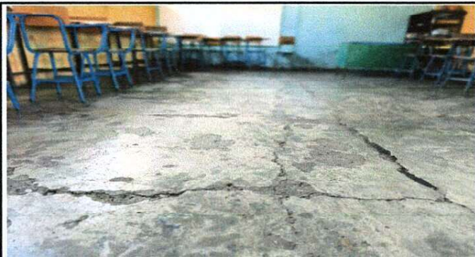
Foto1: Piso de las aulas en malas condiciones, se sustituirá por piso cerámico
