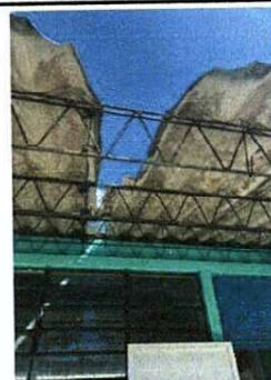
Foto 4: LAMINA DE DURALITA EN MALAS CONDICIONES.
