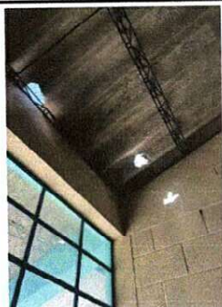
Foto 3: LAMINA DE DURALITA EN MALAS CONDICIONES.
