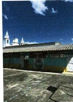
Foto 2: LAMINA DE DURALITA EN MALAS CONDICIONES.
