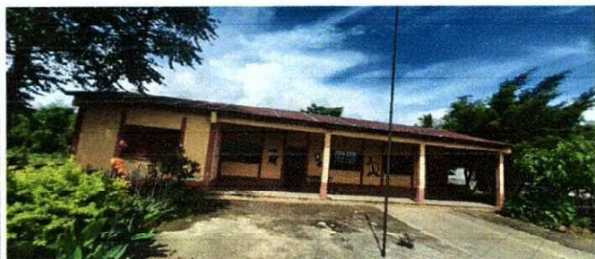
CUBIERTA DE LAMINA EN MAL ESTADO
