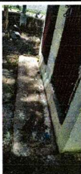
BAÑOS SIN PUERTAS NI PROTECCION
