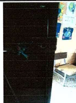
PUERTAS DE METAL SIN PROTECCION
