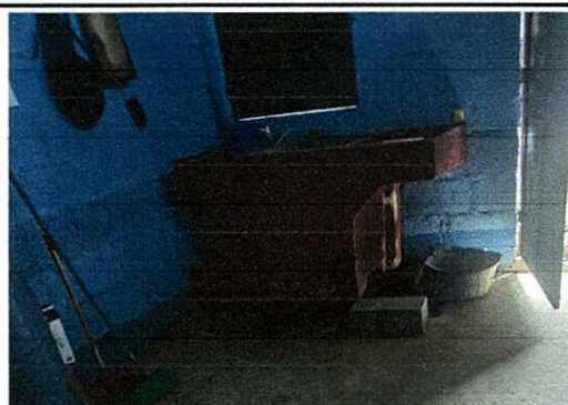
PILA CON FUGAS Y MAL ESTADO
