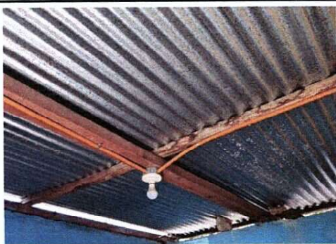
Foto1: Sustrucción de techo.
