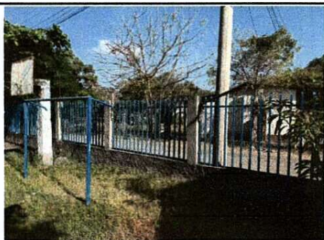
Foto 3: Mantenimientos de balcones de metal
