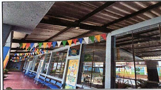
TECHO DE SOPORTE DE MADERA Y LAMINA DE DURALITA EN MAL ESTADO, SE NECESITA CAMBIO
