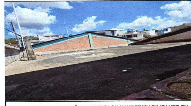
SE NECESITA APLICACIÓN DE MEZCLON Y IMPERMIABILIZANTE EN TERRAZA
