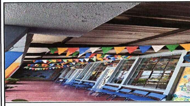
DUCTO Y CABLEADO Y BOMBILLAS EN MAL ESTADO SE NECESITA CAMBIO
