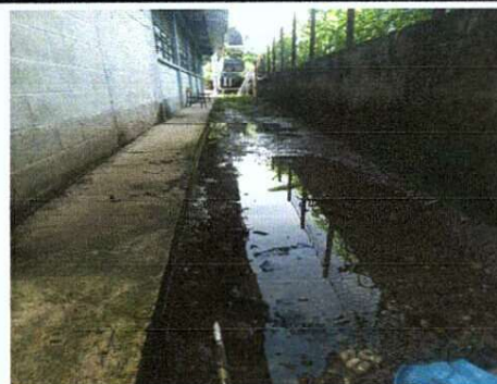
PISO DE CONCRETO AGRIETADO Y CON FILTRACIONES DE AGUA
