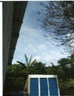
TECHO DE BAÑOS DETERIORADO
