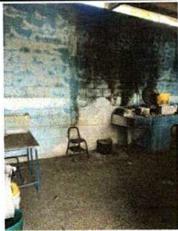
Foto1: NO CUENTA CON AREA DE COCINA.
