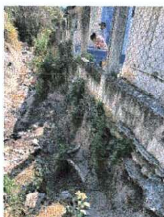
Foto 1: MURO DE CONTENCION DETERIORADO.
