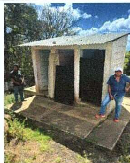
Foto 4: AREA BATERIA DE BAÑO, PUERTAS EN MAL ESTADO DESMONTADAS.
