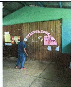
Foto 2: MURO PORTON TIPO BIOMBO EN MALAS CONDICIONES, SE SUSTITUIRA POR ESTRUCTURA
