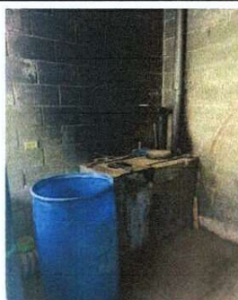
Foto 3: AREA DE COCINA, EN MALAS CONDICIONES.
