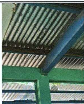
Foto 1: ESTRUCTURA EN MAL ESTADO CORROSION EN ESTRUCTURA METALICA
