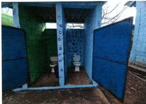
Foto 3: Baños en mal estado
