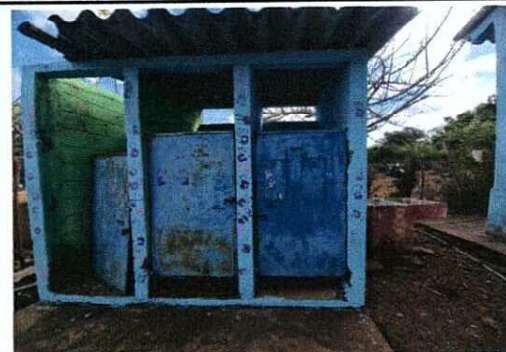
Foto 4: Puertas de baños en mal estado
