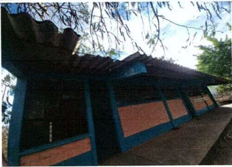
Foto 1: Techo en mal estado
