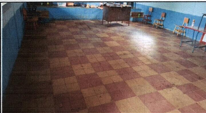
Foto 1: Piso en mal estado, se realizará levantamiento de piso, remover raíz y se instalará piso antideslizante.
