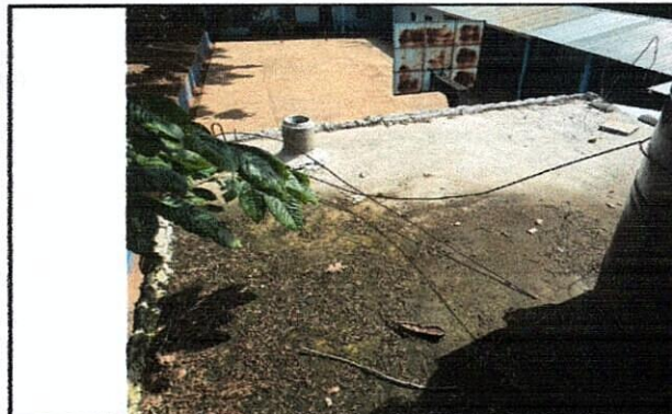
Foto 2: Filtración de agua en la terraza de la cocina, se realizará impermeabilización para impedir que el agua se filtre.
