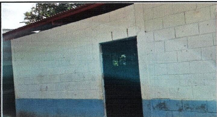
Foto 3: Pared sin columna en una aula, se reforzará con una columna para mejorar la resistencia y durabilidad de la pared.
